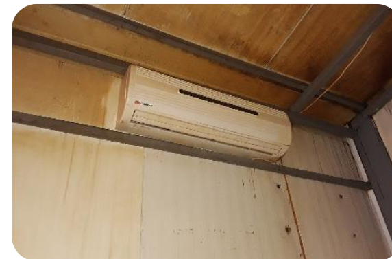
Nr. inv. 20027 - APARAT AER CONDITIONAT
